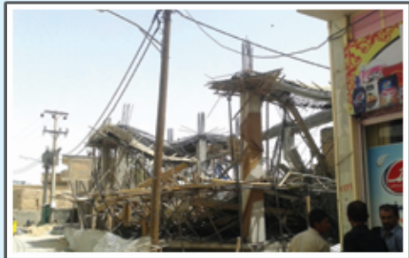
«فروریختن سقف ساختمان در زمان بتن‌ریزی - عکس:محمد جهانپنده»
